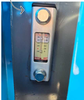
Контроль температуры гидравлической жидкости
